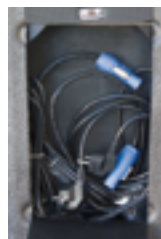
Departamento para cables
