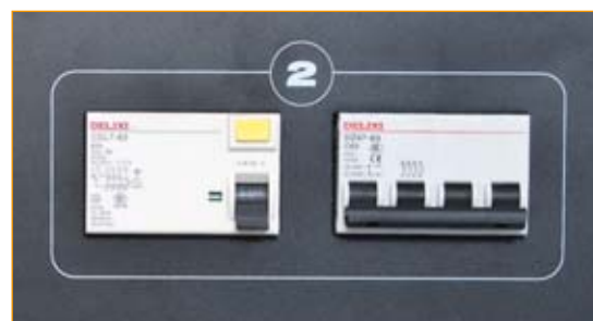
Protecciones con diferencial y magnetotérmico de 4 polos en cada dimmer.
